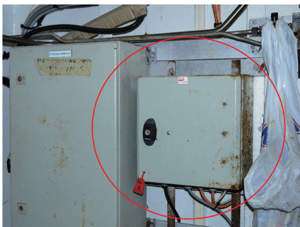
図6. Kato号の船首倉庫に設置された自動監視装置Blue Box。装置は封印されており、作業中に開くことはできない。
